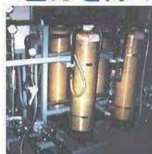
いん ころかんじゆ し そう ち 陰イオン交換樹脂装置
